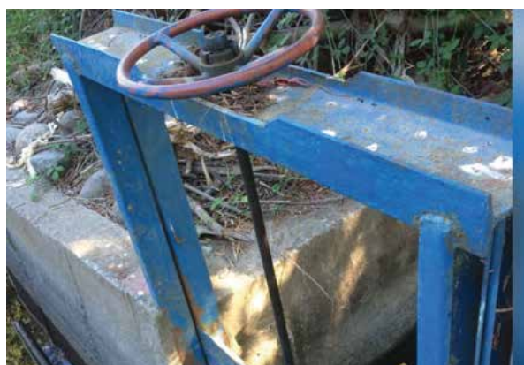
Compuerta Canal Reloca.
